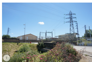
1 Vue sur le poste de transformation existant de Lauras, commune de Roquefort-sur-Soulzon.
