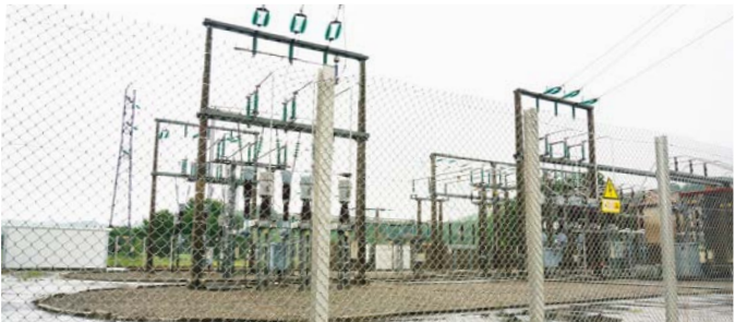
L'ensemble de la composition du poste apparaît au premier regard
