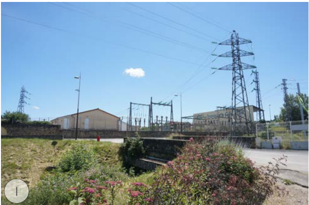
1 Vue sur le poste de transformation existant de Luras, commune de Roquefort-sur-Soulzon.
