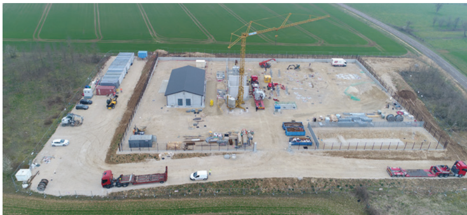
Poste source de Vingeanne, RTE
