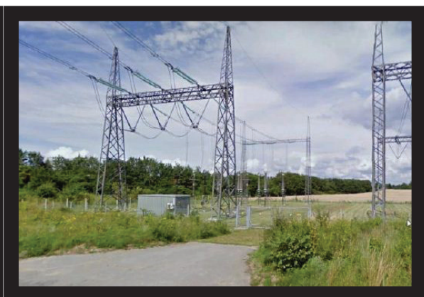
Poste aéro souterrain au Danemark.
