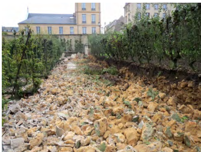
L'effondrement du mur du côté sud du 5e des Onze, vue vers l'Est octobre Crédits : ensp/aj
