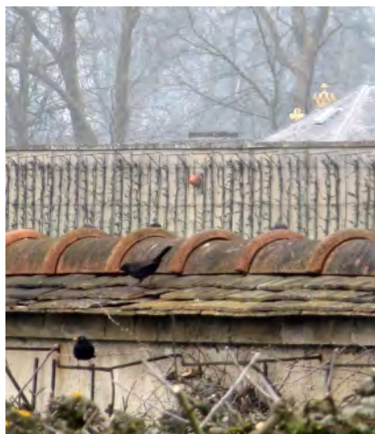
Deux jeunes merles sur la faîtière du mur qui est tombé en octobre 2013 (photo de mars 2013)
